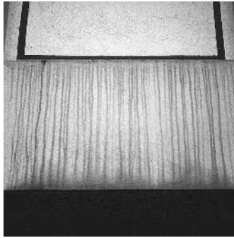
Abb. 20: Vermeidbare Fassadenverschmutzung durch fehlende Fensterbankabdeckung
