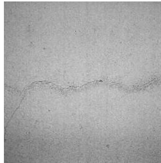
Abb. 16: Schmutzablagerungen im Verlauf feiner Risse sind die Folge der Wasseraufnahme des Risses und können die optische Störwirkung solcher Risse erheblich vergrößern.
