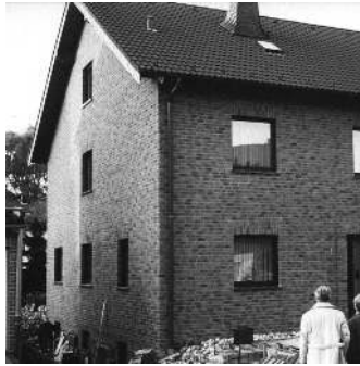
Abb. 2: Die Störwirkung optischer Mängel – hier von Ungleichmäßigkeiten an der Verblendschale – ist aus der gebrauchstypischen Position eines Betrachters zu beurteilen.
