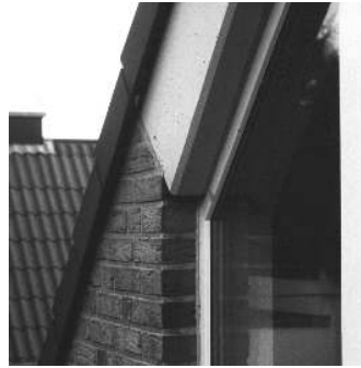
Abb. 3: Die dargestellte Maßabweichung am Anschluss eines Betonsturzes ist aus gebrauchstypischem Abstand sichtbar, aber nicht auffällig störend.
